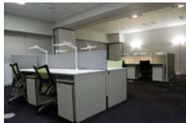
技術研究所における、タスク&アンビエント照明で調光制御実験
