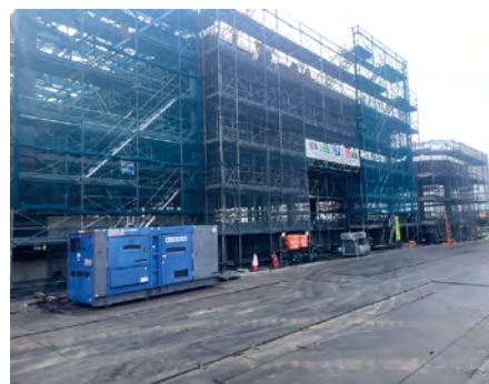
サステオ51 ※2 を使用した発電機 (協力:カメイ株式会社)
