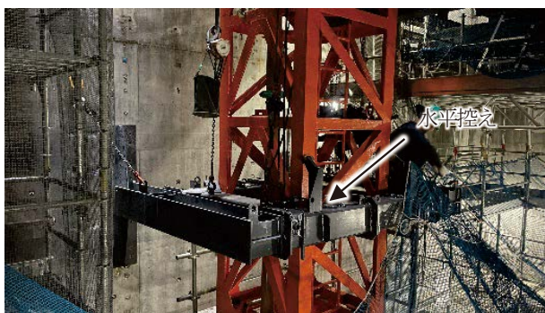
写真6 ディストリビューター支柱の水平控え
