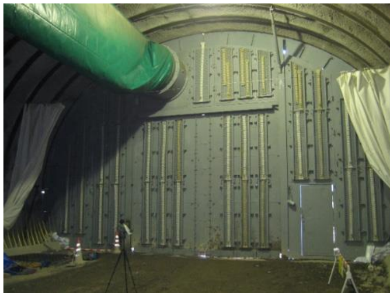
山岳トンネルの坑口に設置された「剛性付加式防音扉」
